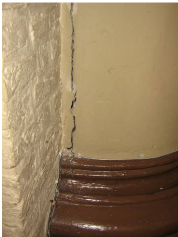
Scheur bij overgang van kerkzaal naar koor
