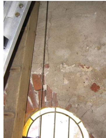
Verticale scheur zuidwestelijke toren
