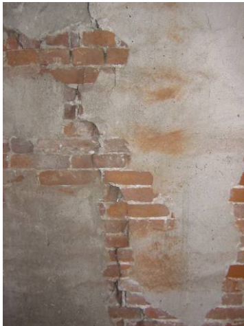
Verticale scheur zuidwestelijke toren
